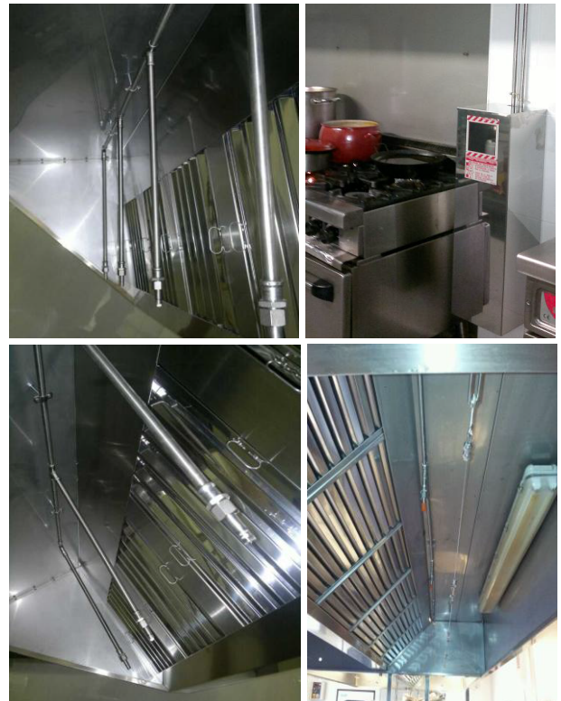
Fotos: Armario y líneas del sistema CROCADE.
